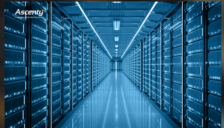
INFRAESTRUTURA DOS 24 DATACENTERS
